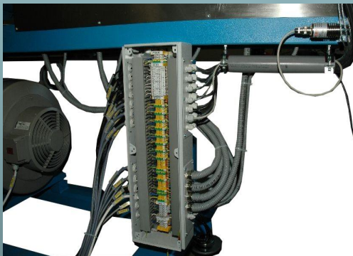
PODŁĄCZENIE WYTŁACZARKI DO SZAFY +SW
