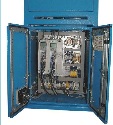
SZAFA ODCIĄGU +SS
