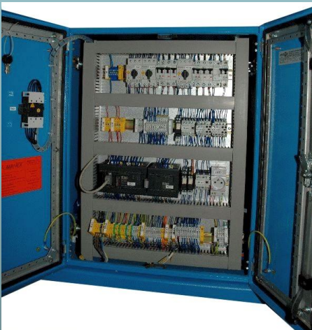
SZAFA ODCIĄGU +SS
